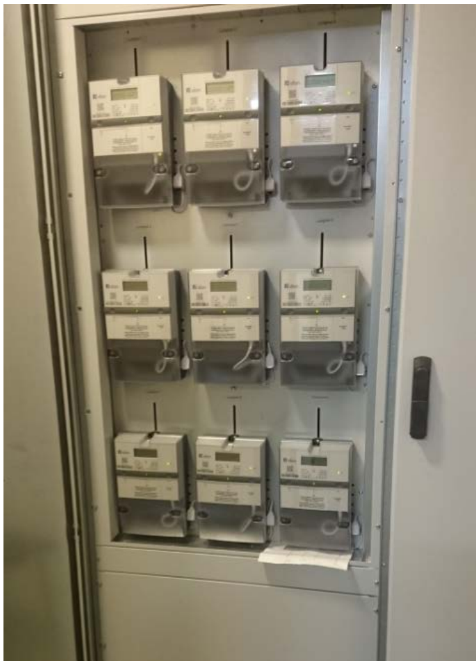
Figur 18: Ni målere plassert i samme skap i en boligblokk på Skjærran, Evenskjær.
